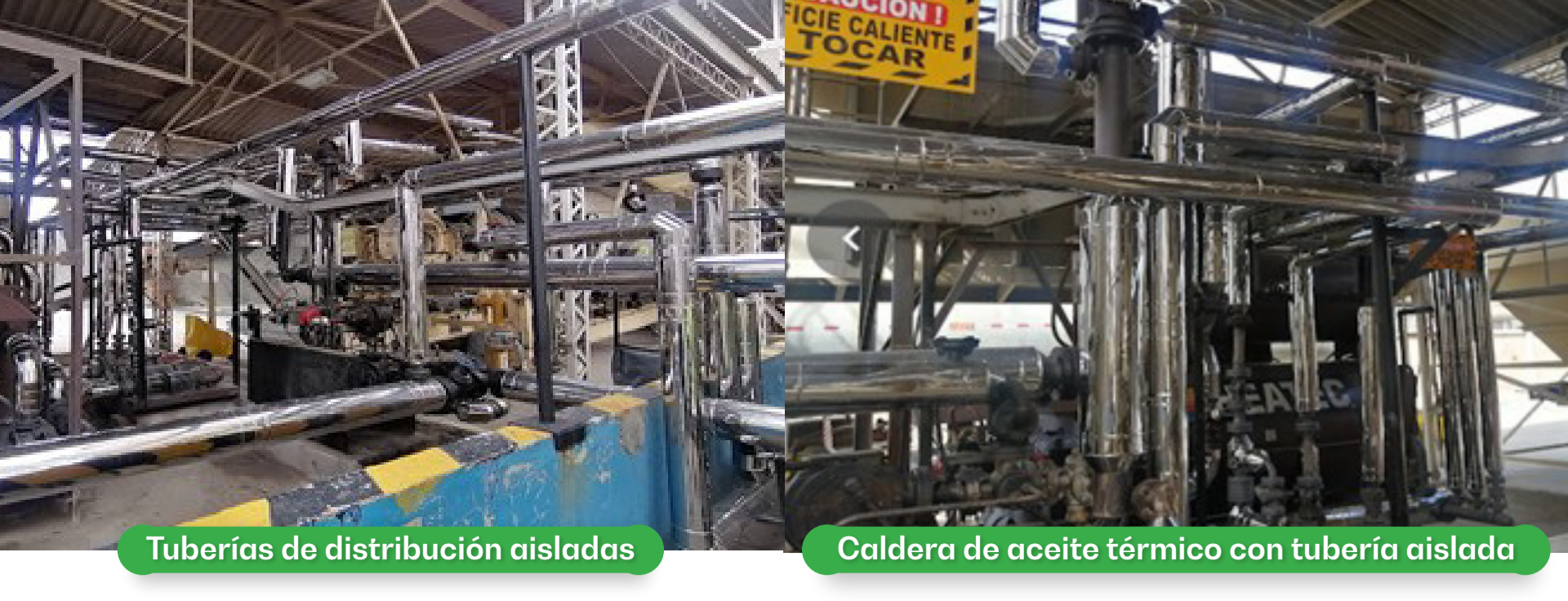
Tuberías de distribución aisladas
