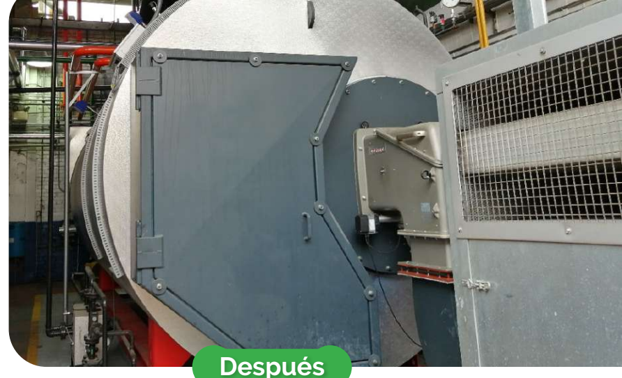
Caldera piro tubular de 1000 BHP de tres pasos con economizador y quemador con modulación electrónica.
