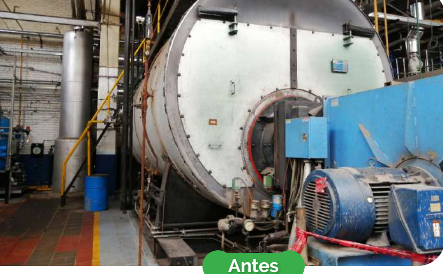
Caldera piro tubular de 1000 BHP de tres pasos, sin uso de economizador, la caldera tiene una edad de 6 años.
