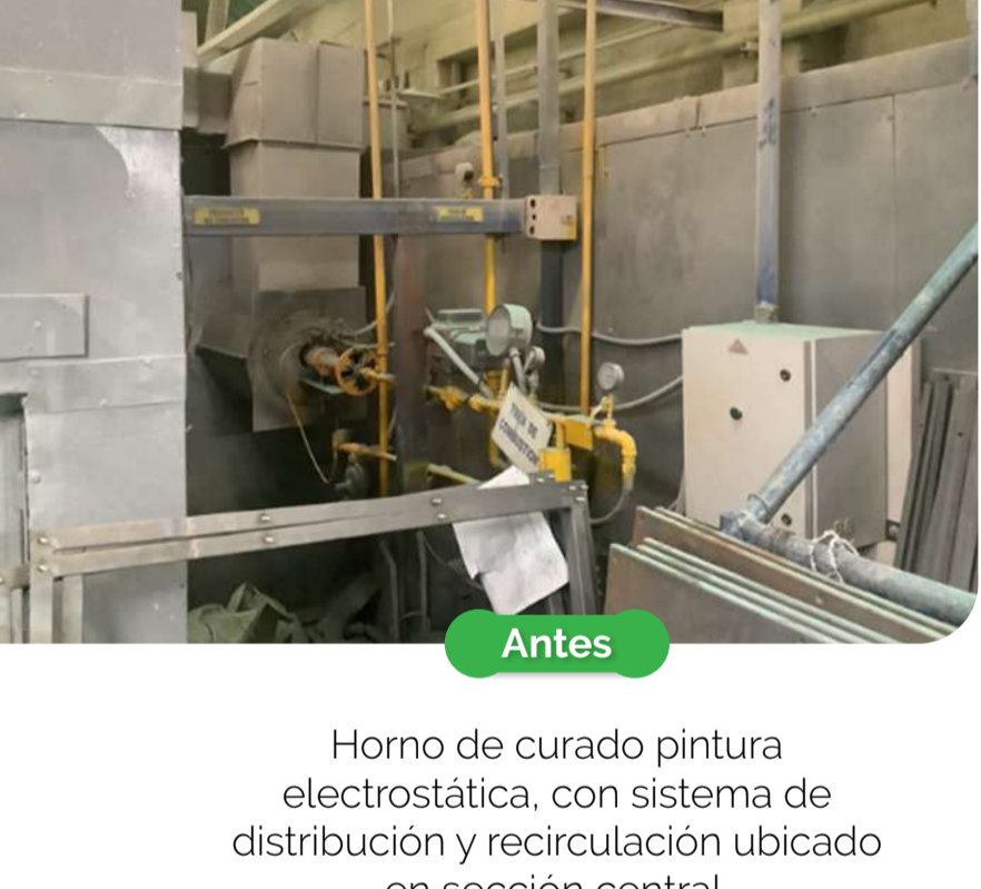
Antes Horno de curado, con pintura electrostática, con sistema de distribución y recirculación ubicado en sección central.
